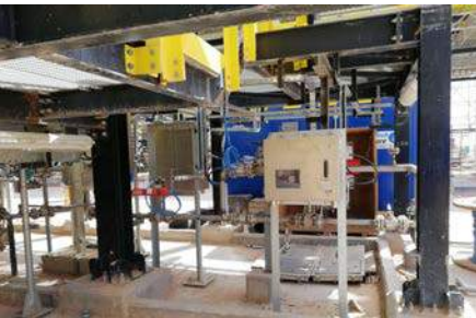
TOUATGAZ PROJE - DOĞALGAZ İŞLEME VE ÜRETİM TESİSLERİ PROJESİ
