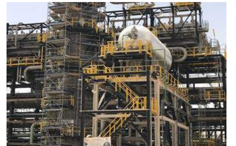
TOUATGAZ PROJE - DOĞALGAZ İŞLEME VE ÜRETİM TESİSLERİ PROJESİ
